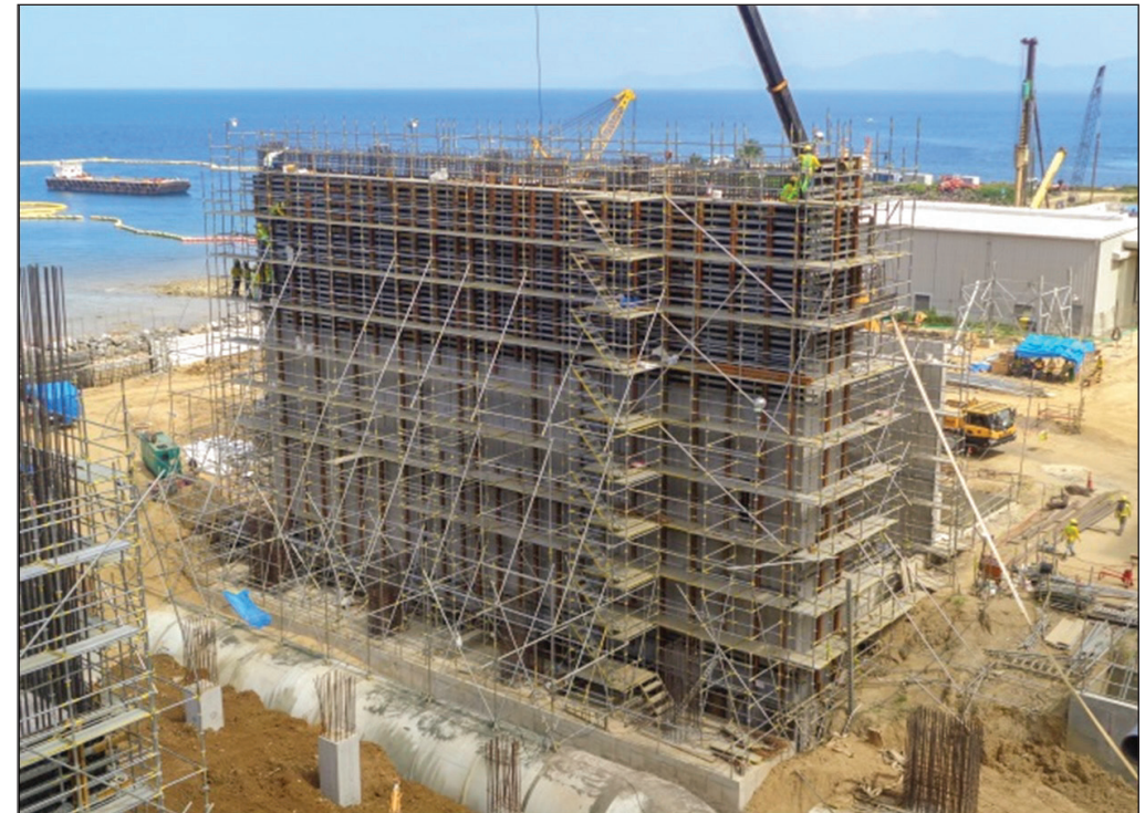
EFCO diseñó ensambles de 30 m de largo y 6 m de altura con E-BEAM® y SUPER STUD® para construir fácilmente los muros de la estructura en tres vaciados en altura.
